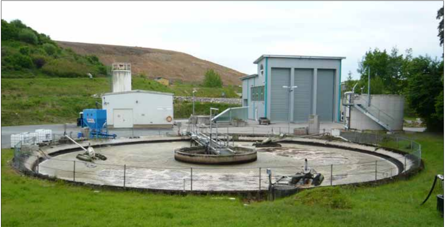
Abb. 6: Gesamtansicht der Sickerwasserreinigungsanlage
