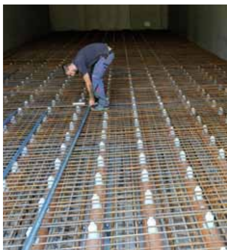
Abb. 26: Im Boden der neuen Rotteboxen-integrierte Lüftungstechnik.
