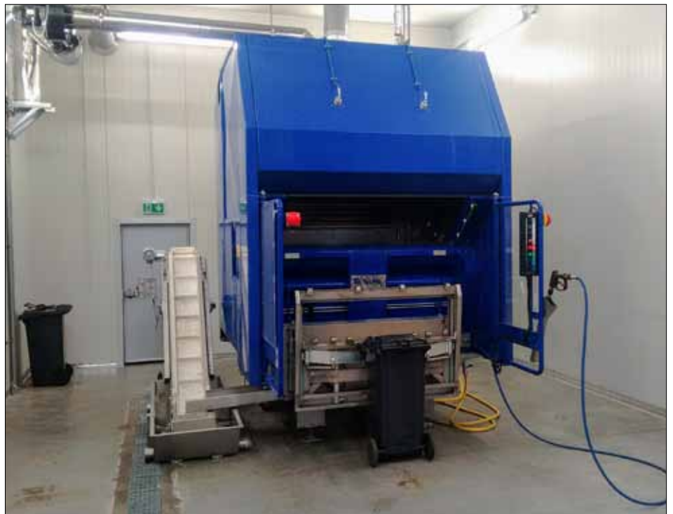
Abb. 36 Die mobile Lösung wurde durch eine eigene stationäre Waschanlage für Abfallsammelbehälter ersetzt.
