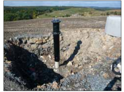
Abb. 12: Anschlussstück auf gelochtem Gassammelrohr
