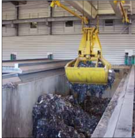
Abb. 29: Befüllung der Rotteboxen der MBS-Anlage mit zerkleinertem Restabfall
