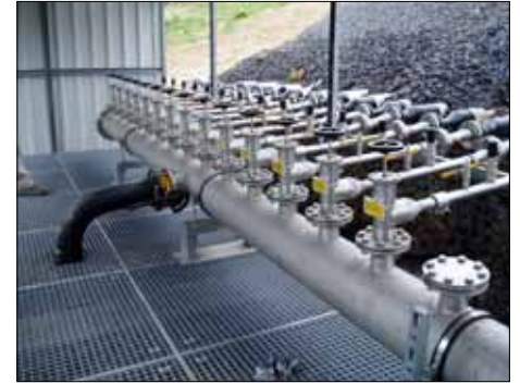
Abb. 15: In Gassammelstation ankommende Gassammelleitungen der einzelnen Gasbrunnen
