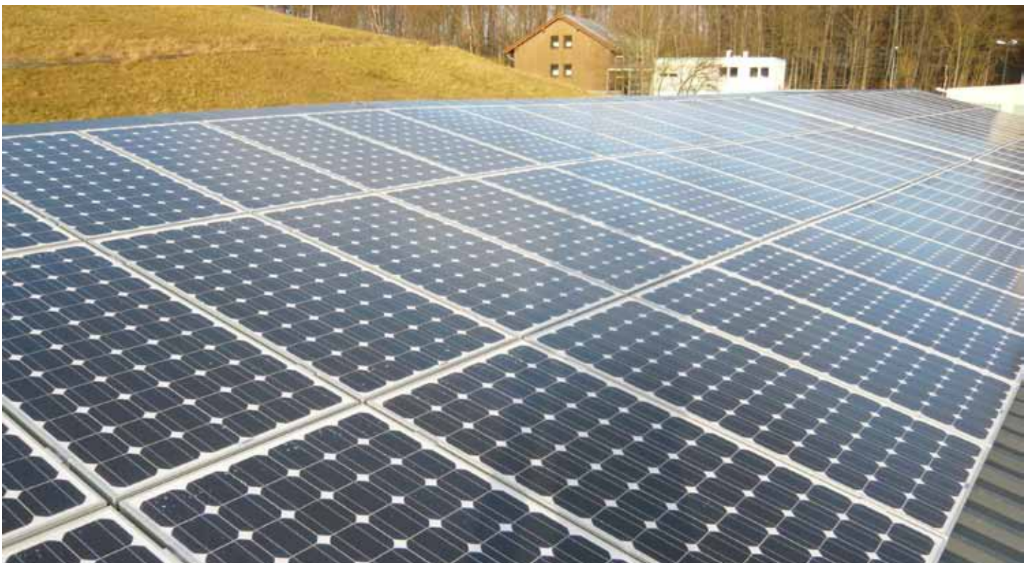
Abb. 41: Teil der Photovoltaikanlage auf den Dachflächen des Abfallwirtschaftsbetriebes
