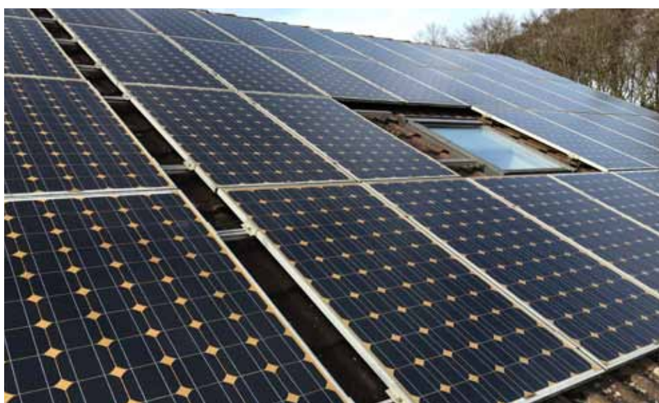
Abb. 76:: PV-Anlage auf dem Dach des Betriebsgebäudes des AWB
