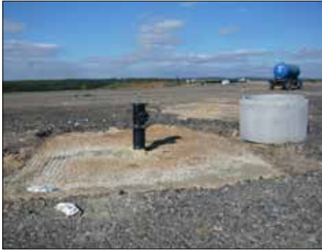
Abb. 13: In Tonschicht gasdicht eingebetteter Brunnenkopf
