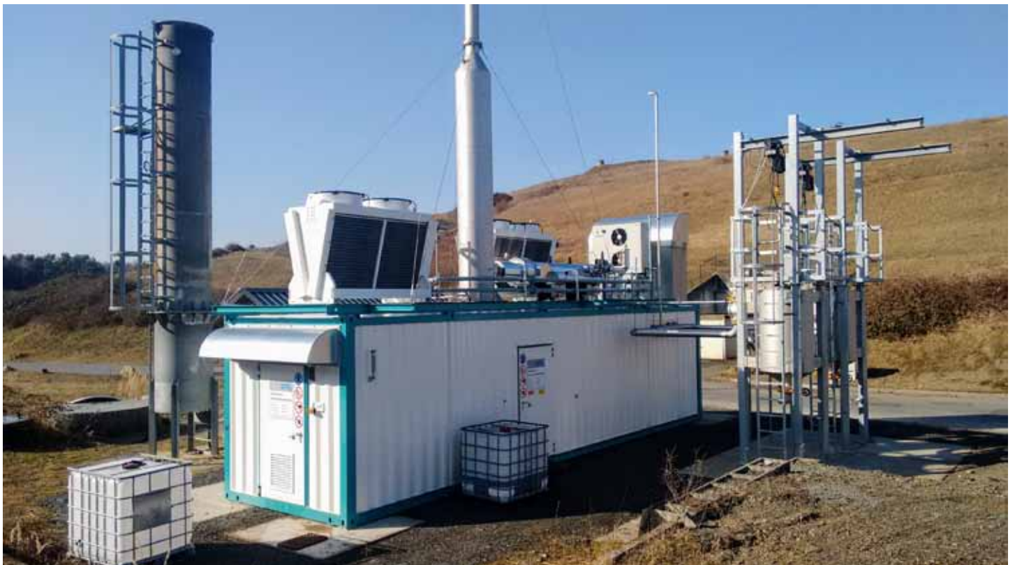
Abb. 16: Das 2016 erneuerte Blockheizkraftwerk (BHKW) zur Deponiegasverwertung. Gas wird klimafreundlich verstromt und die Abwärme des Motors zum Beheizen der Gebäude genutzt. Das BHKW wird vom Abfallwirtschaftsbetrieb ab 2017 in Eigenregie betrieben.
