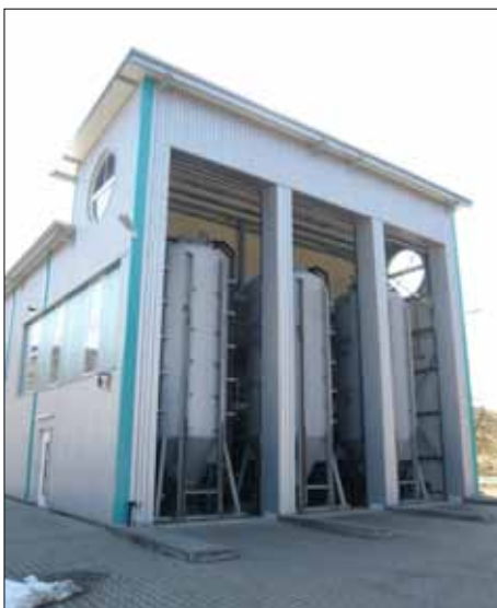
Abb. 7: Aktivkohlefilterstufe zur Nachreinigung des Deponiesickerwassers
