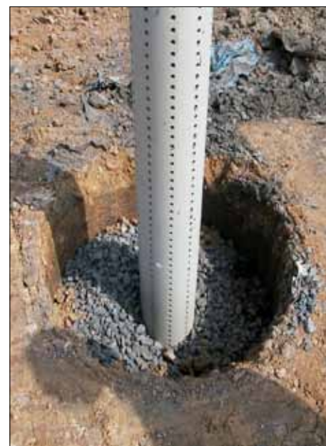
Abb. 11: Gelochtes Gassammelrohr in Drainageschicht aus Schotter
