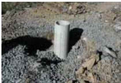
Gasbrunnen bestehend aus gelochtem Kunststoffrohr und Schottermantel
