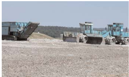
Moderne Verdichter bauen den Abfall ein
