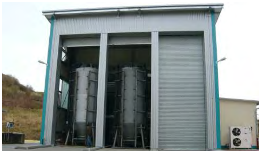
Blick auf die Aktivkohlefilter der Sickerwasserreinigungsanlage
