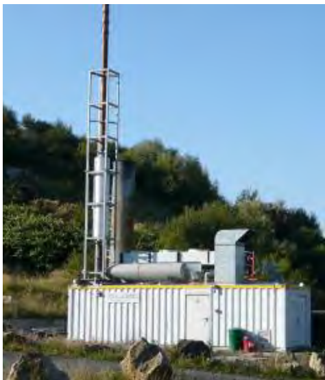
In der Deponiegasverwertungsanlage wird aus Deponiegas elektrischer Strom gewonnen
