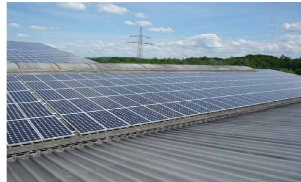
Abb. 3: Photovoltaikanlage auf dem Dach der Kompostanlage Beselich
